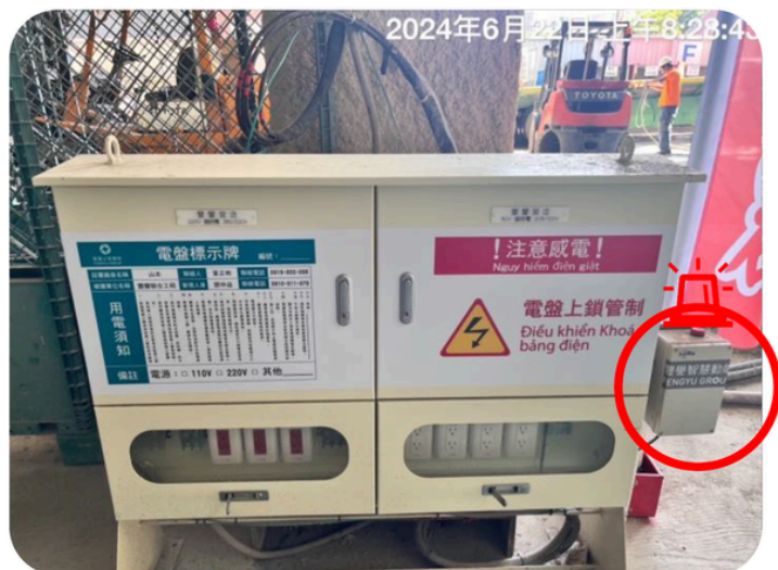
臨時電盤開啓即時監控
