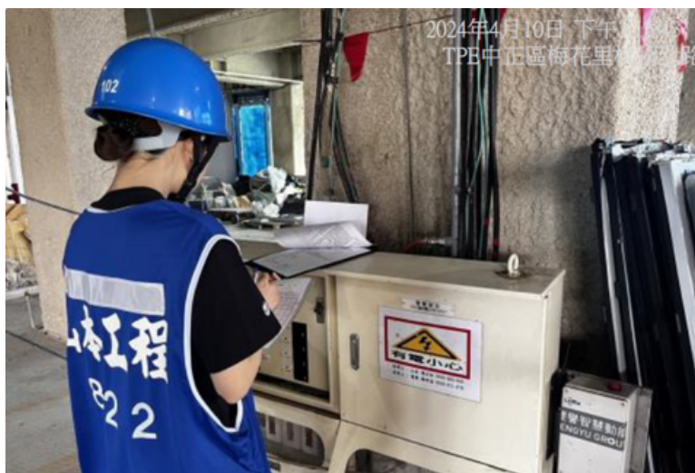
電氣設備定期巡檢
